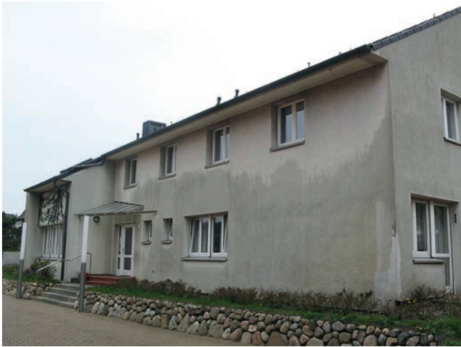
Bild 5. Die hohe Schlagregenbeanspruchung in Norddeutschland begünstigt zusätzlich den Algen- und Pilzbefall bei Fassaden aus WDVS Fig. 5. High pelting rain load in northern Germany increases alga and fungal attacks at ETICS façades
