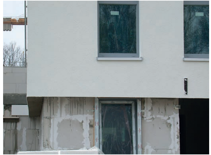
Bild 7. Die große Dämmdicke und die dünne Putzschicht sind maßgebend dafür, dass sich die Putzoberfläche stark abkühlt und unter die Lufttaupunkttemperatur fällt Fig. 7. This high insulation thickness and the thin plaster layer are decisive for the plaster surface cooling intensively down under the air dew point
